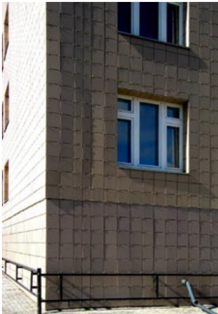
Облицовка фасада пошла волнами.
