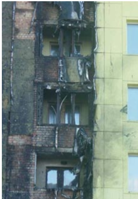
Сгоревший фасад жилого дома. Был использован горючий композит.
