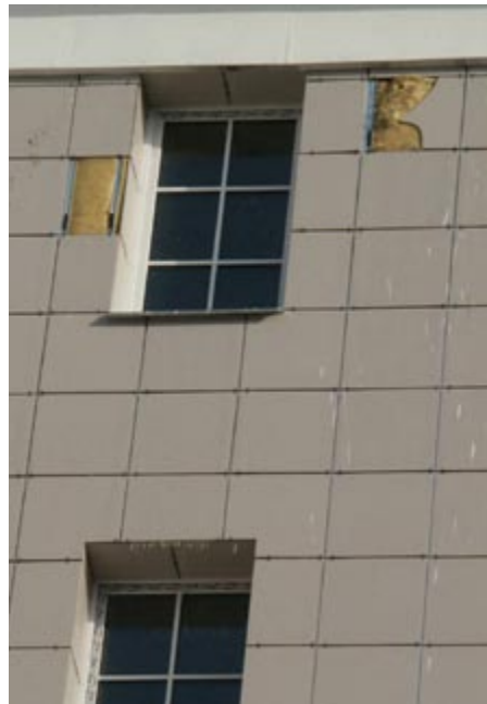
Отсутствие воздушного зазора привело к увлажнению под облицовочными плитами и их разрушению.
